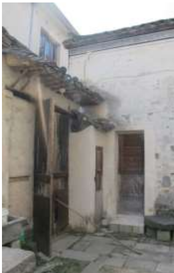
图 2-6 上水圳春晖堂建的厕所
