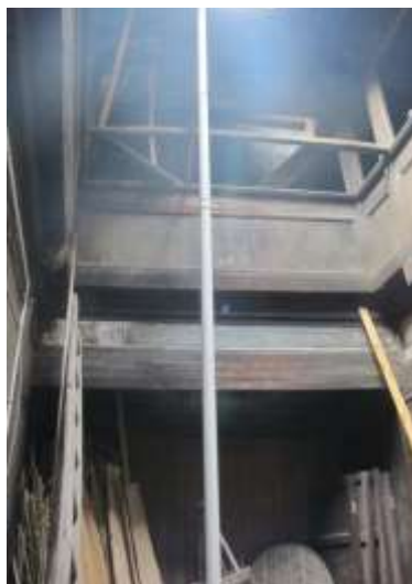
图 2-5 吴氏祠堂附近（东边井 29 号） 损坏的屋顶用木棍支撑着
